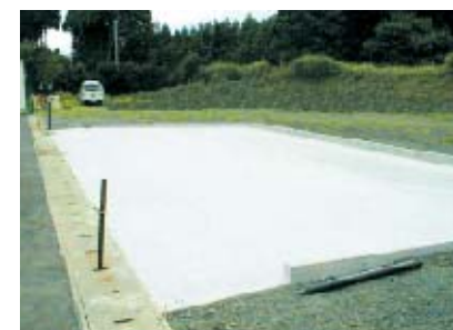
廃油などの地下浸透を防ぐ、油水分離層付き 廃棄物置場(平成11年5月設置)
