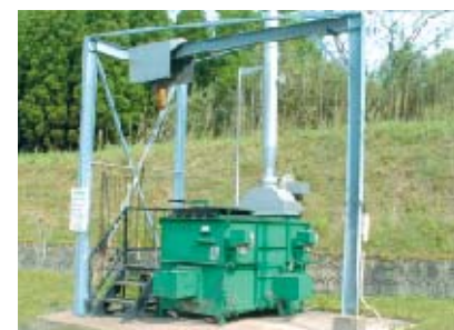
半ガス化燃焼方式による消煙型焼却炉 (平成11年5月設置)
